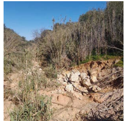
Acumulación de restos de vegetación (cañas) que taponan el barranco del mismo nombre e impiden el curso normal del agua.
